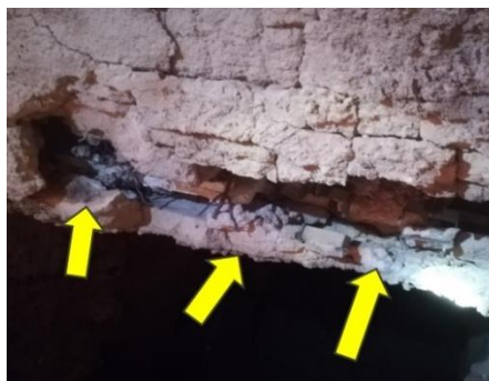
Foto 7: Schade aan de vuurvaste bekleding
